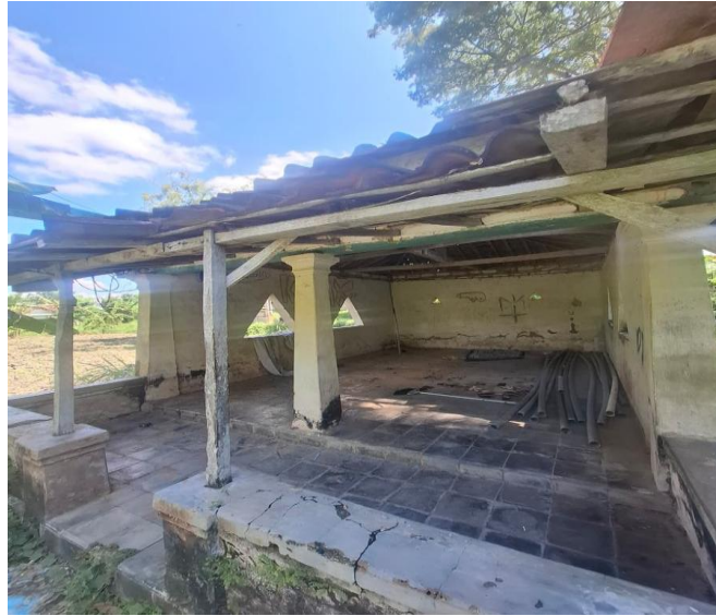
Gambar 3. Kondisi Fisik Bhaqaf yang Rusak dan Terbengkalai atap runtuh, dinding berlumut, dan lantai tidak terawat sebagai bukti nyata penurunan eksistensi bhaqaf (Dokumentasi Penelitian, April 2026)
